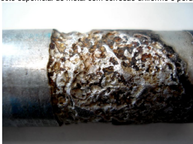
Figura 12 Aspecto superficial do metal com corrosão uniforme e perda de espessura
