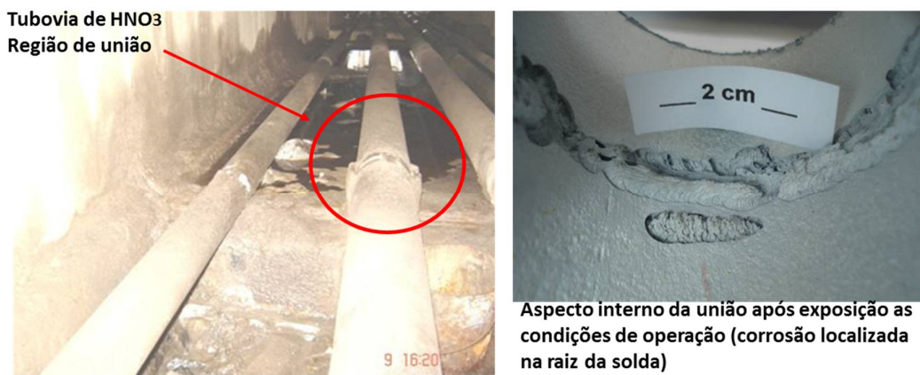
Figura 2 Aparência interna da união após exposição às condições de operação (corrosão localizada na raiz do cordão)
