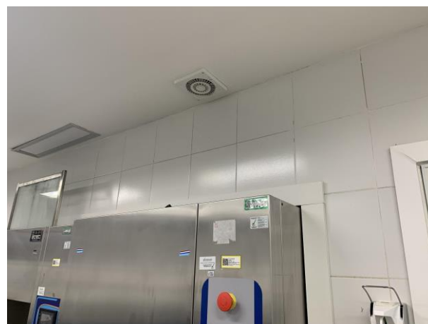
Figura 45: Exaustor na sala de recepção e descontaminação acima da termodesinfectora
