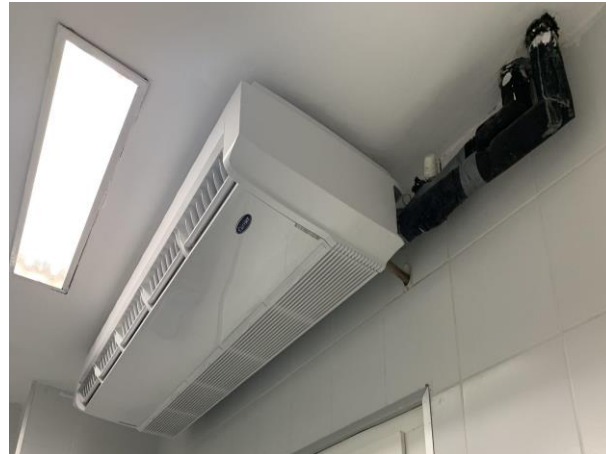
Figura 30: Climatizador de ar tipo fancolete com tubulação exposta
