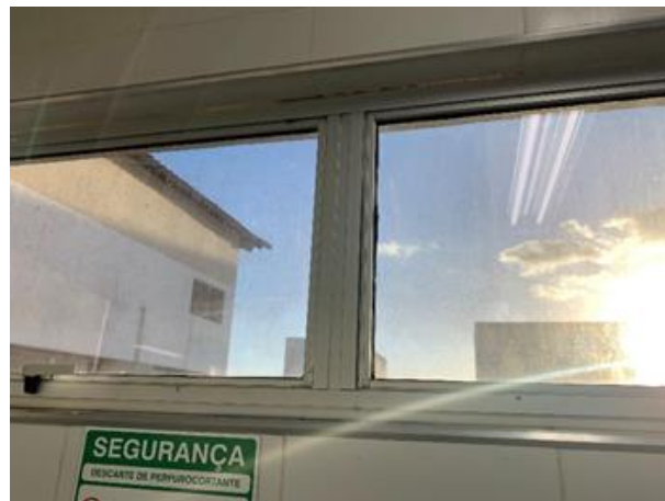
Figura 32: Janela de acesso luminoso na área de desinfecção química
