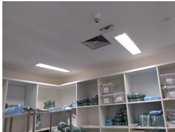
Figura 14: Armário com vão aberto na sala de armazenamento de materiais esterilizados
