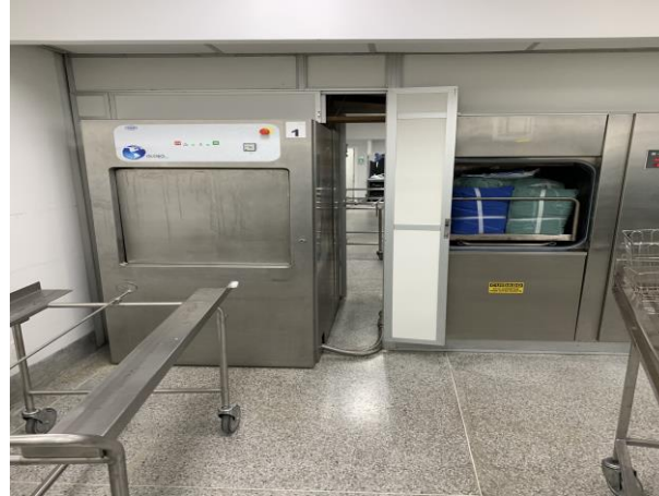
Figura 40: Porta de acesso para manutenção aberta comunicando-se com a área de limpeza
