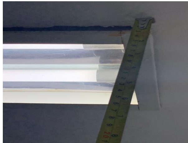
Figura 26: Abertura de aproximadamente 3cm com o teto para luminária de sobrepôr no setor de armazenamento de materiais esterilizados.
