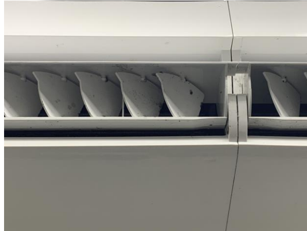
Figura 46: Formação de fungos nas aletas de saída de ar do climatizador de ar
