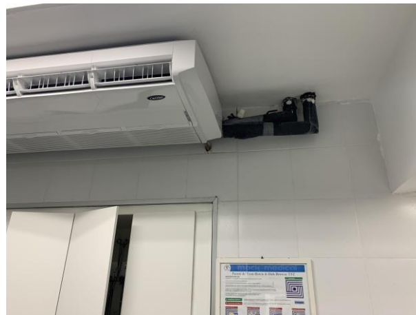
Figura 29: Climatizador de ar tipo fancolete
