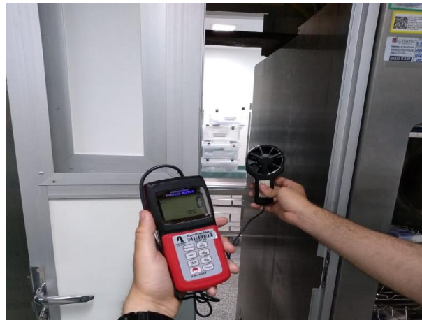
Figura 6.1: Medição de fluxo de ar Sala de Preparo - Sala de Esterilização
