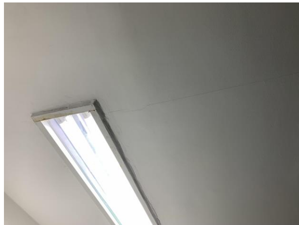
Figura 25: Luminária de embutir e rachadura no teto do setor de armazenamento de materiais esterilizados
