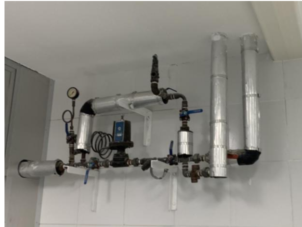
Figura 36: Linha de alimentação de vapor
