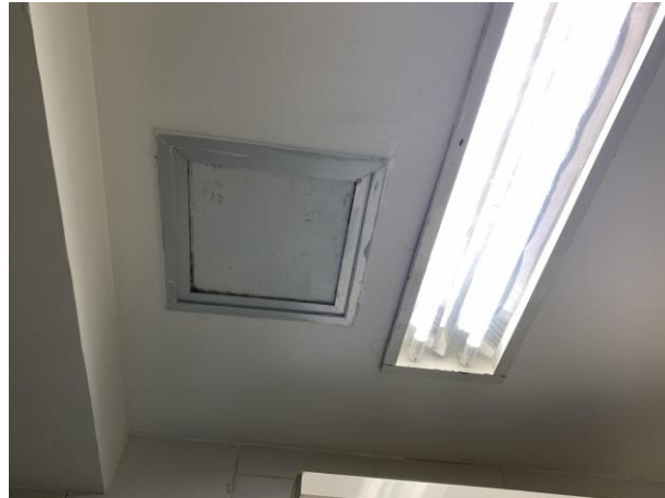
Figura 24: Luminária de embutir e tampa de acesso no setor de desinfecção química
