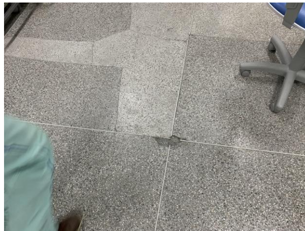
Figura 17: Piso danificado no setor de armazenagem dos materiais esterilizados
